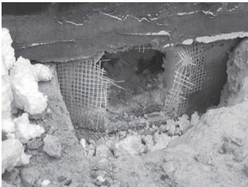
Rys. 4.3. Punktowe zagruntowanie powierzchni ściany przy braku izolacji pionowej w pasie rozprysku wody od powierzchni gruntu do wysokości 0,5 m powyżej poziomu terenu przyczyną zawilgocenia ściany po drugiej stronie przegrody [20]
