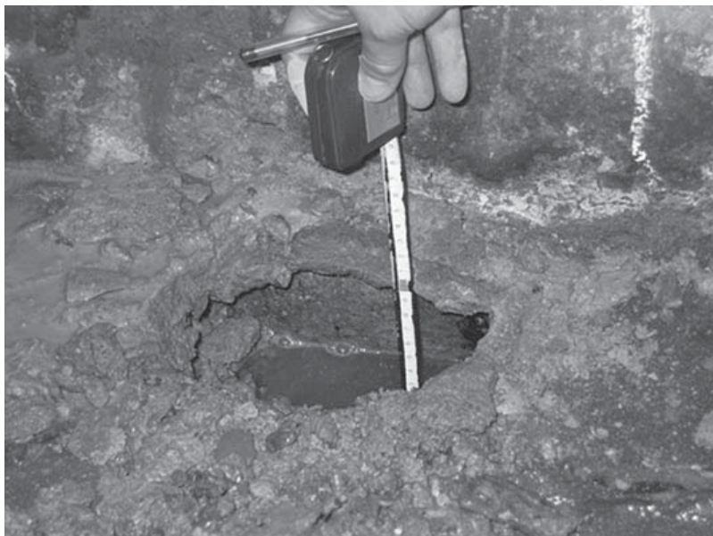
Rys. 4.2. Brak izolacji poziomej posadzki i podciąganie kapilarne wody przez konstrukcję [20]
